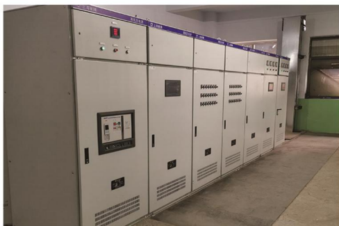
电除尘高低压配电系统
