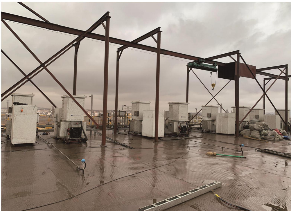
静电除尘运行案例三
