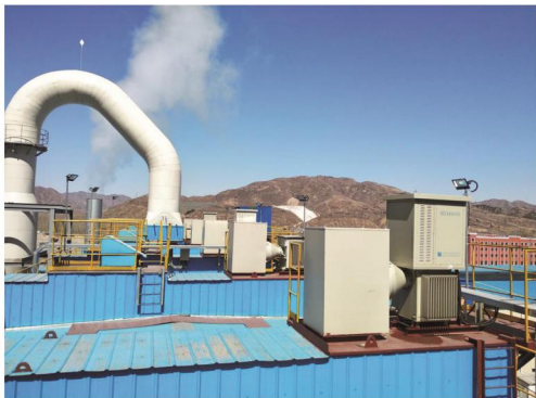
静电除尘运行案例一
