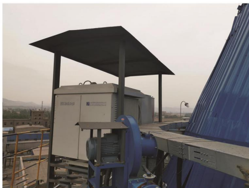
湿式静电除尘运行案例二
